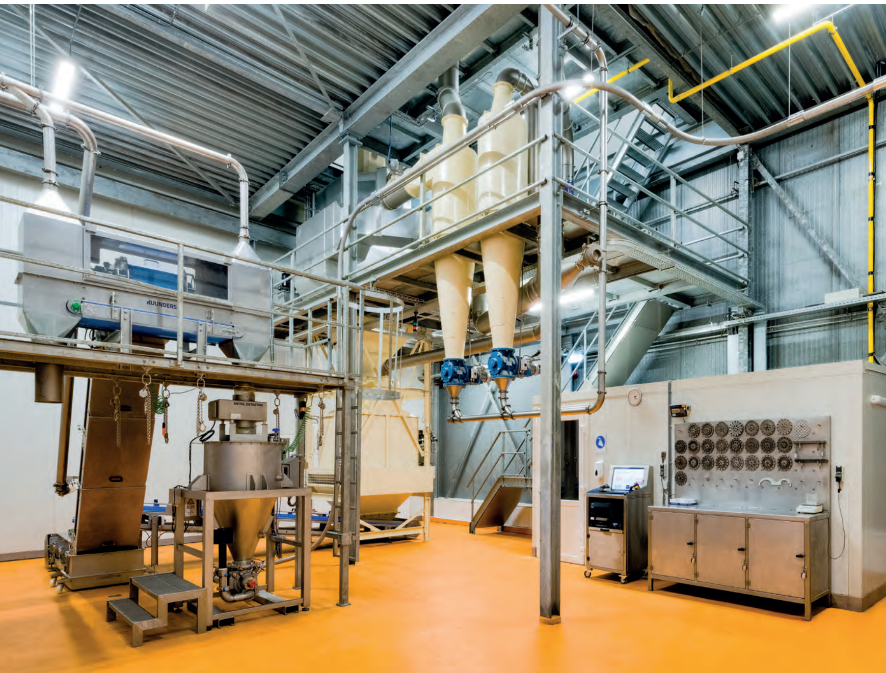
Afb. 1 Extrudaat gaat via een metaaldetector in het buffervat van de eerste pneumatische transportlijn (links van het midden). Deze hopper is voorzien van een hygiënische, snel demontabele DMN draaisluis. Voorts heeft Airtechnic Solutions de stofafzuiging gerealiseerd (rechts van het midden) van twee cyclonen van de tegenstroomkoeler. Deze cyclonen zijn voorzien van VDL draaisluizen.
