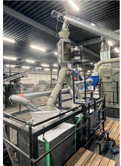
Afb. 3 De inloop van het big bag vulstation met een ontijzeringsmagneet en wisselklep.
